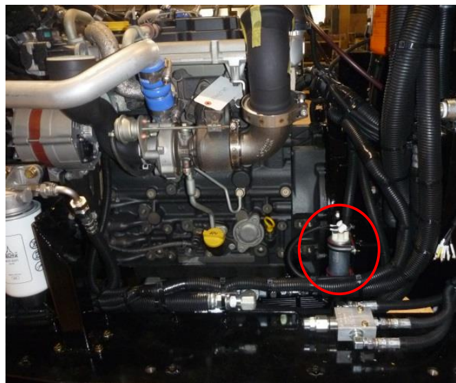
機関室内部写真
