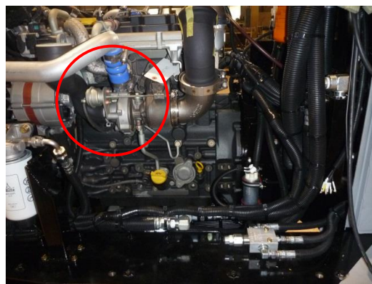
機関室内部写真
